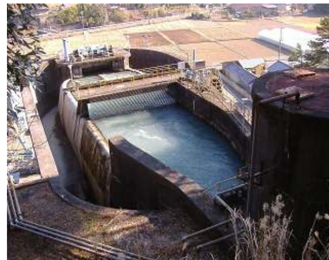
赤松水力発電所
