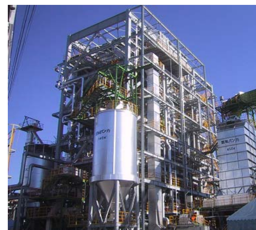
バイオマスボイラー
