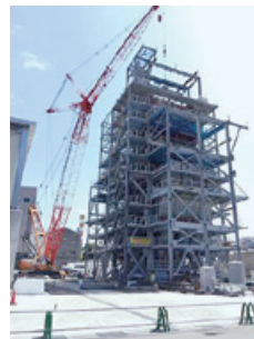
新バイオマスボイラー
