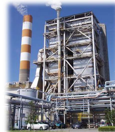
回収ボイラー (R1B)
