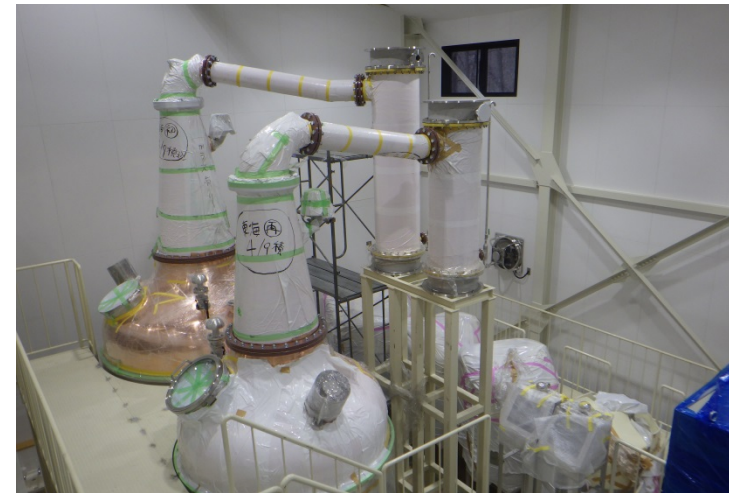
据え付けられたポットスチル(奥:初溜 手前:再溜)
