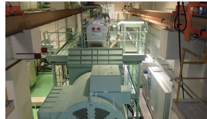
三島工場ガスエンジン発電機
