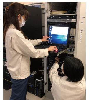
システム点検の様子
