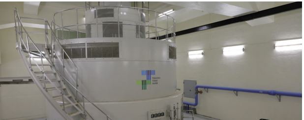
赤松水力発電所
