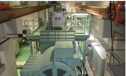
三島工場ガスエンジン発電機
