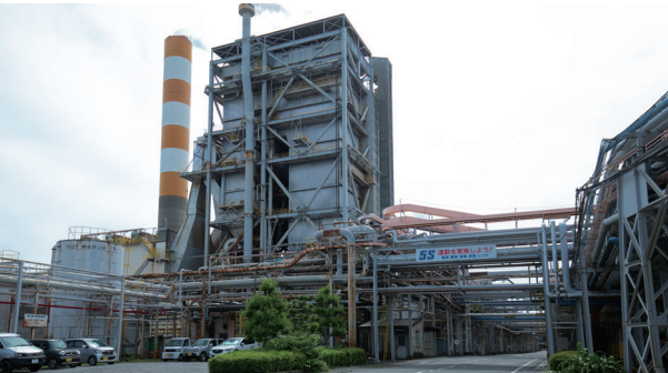
黒液回収ボイラ
