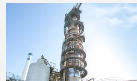
カミヤ式連続蒸解釜 (パルプ生産設備)
