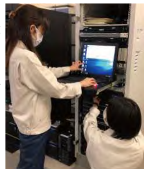
システム点検の様子
