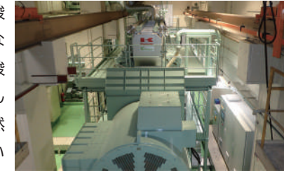
三島工場ガスエンジン発電機
