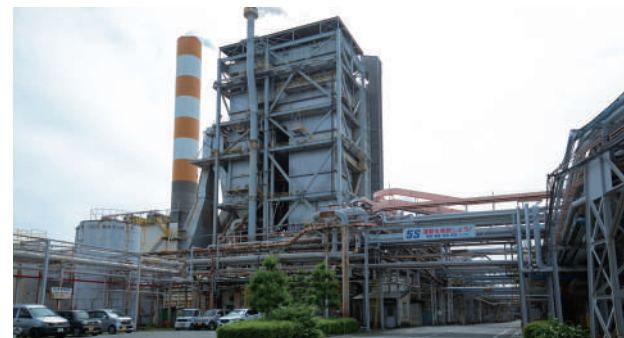
黒液回収ボイラ
