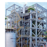
バイオマスボイラー
