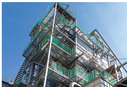
バイオマスボイラー
