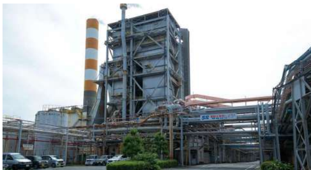
黒液回収ボイラ
