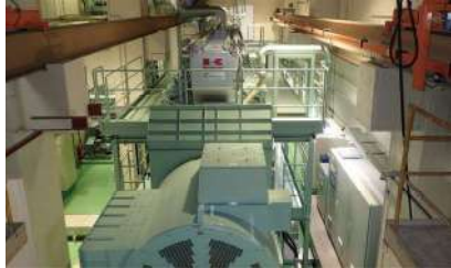
三島工場ガスエンジン発電機
