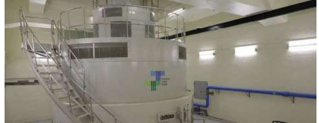
赤松水力発電所
